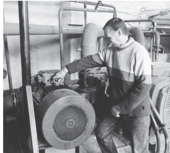
▲ Проверка насосов перед пуском в котельной №5
